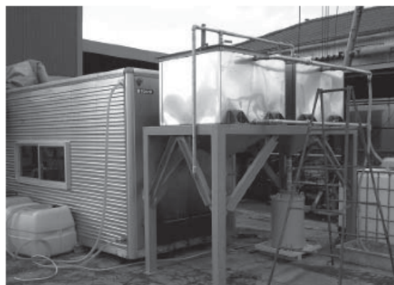
Рис.5. Передвижное технологическое оборудование для очистки жидких радиоактивных отходов.
